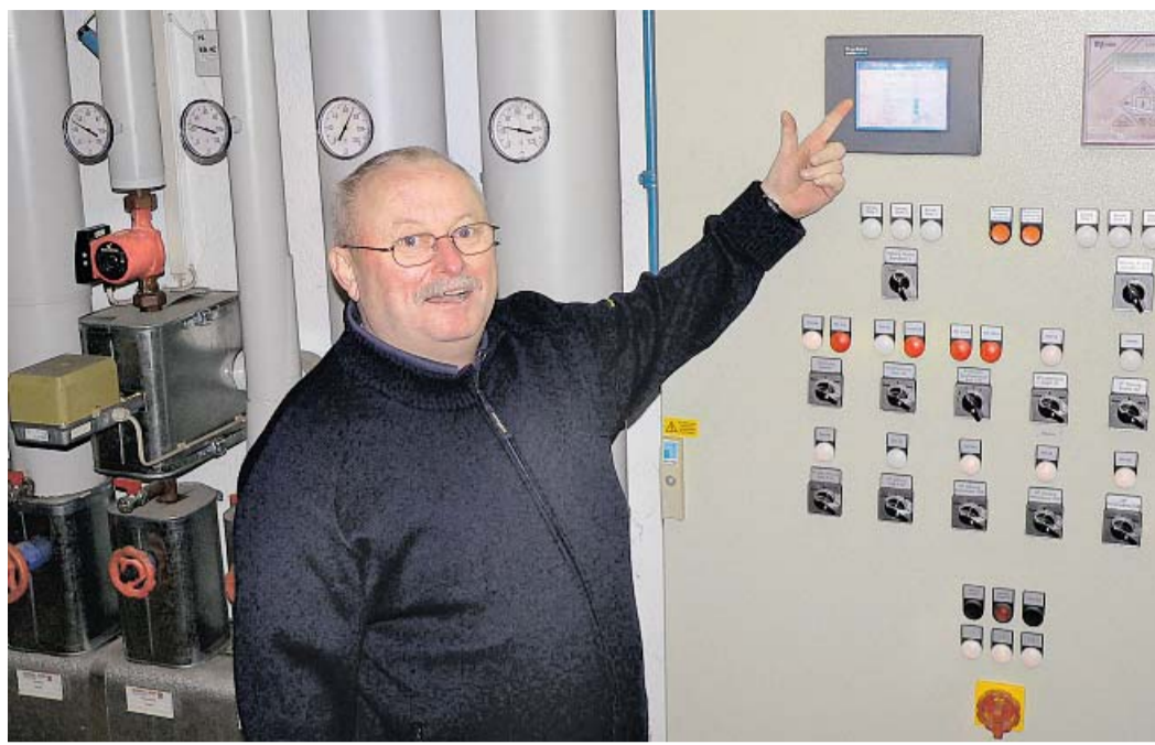
Zu teuer: Norbert Pappenberger würde die Heizung gerne auf Holzpellets umstellen.
